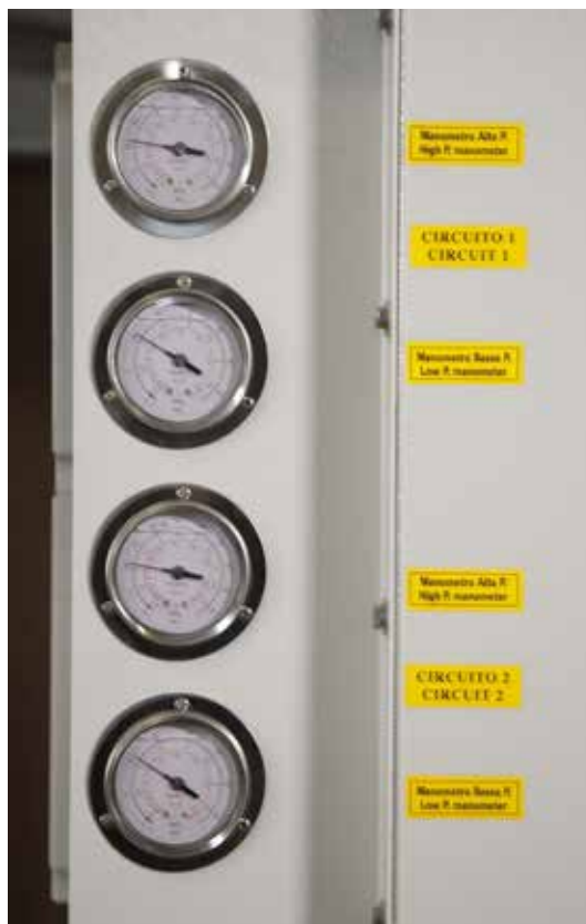
Manometri circuito frigorifero - Refrigerant gauges
