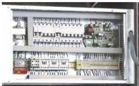
Quadro elettrico modulare Modular electrical cabinet
