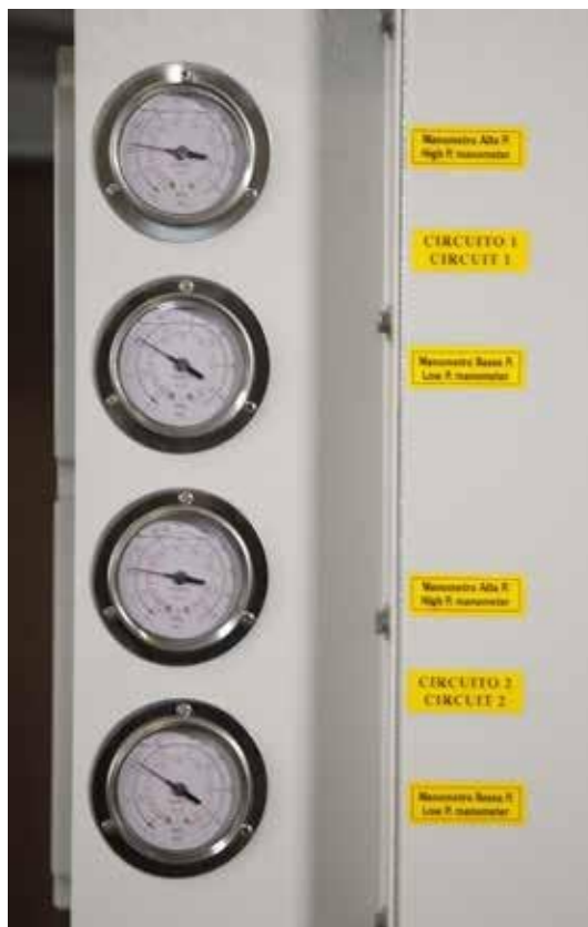
Manometri circuito frigorifero - Refrigerant gauges
