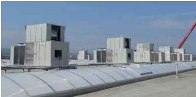
ROMANIA roof-top KRSAY 202 EM COMPACT
